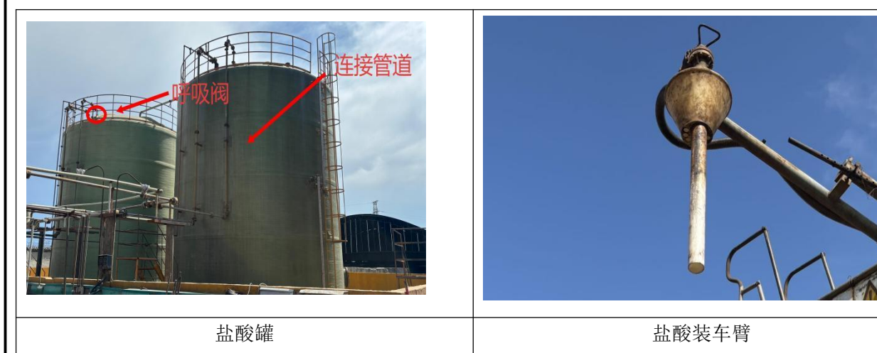
图 3-2 废气储运系统设施
