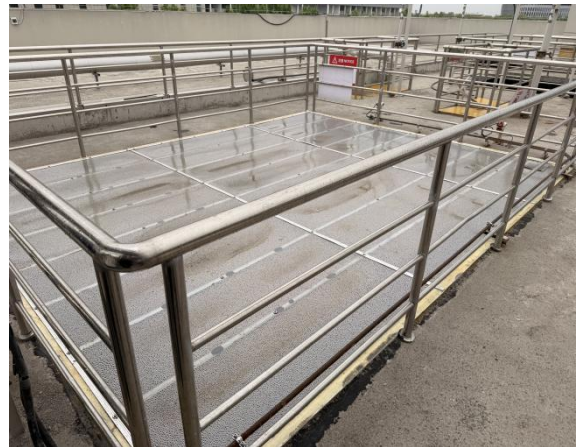
污水处理池加盖板
