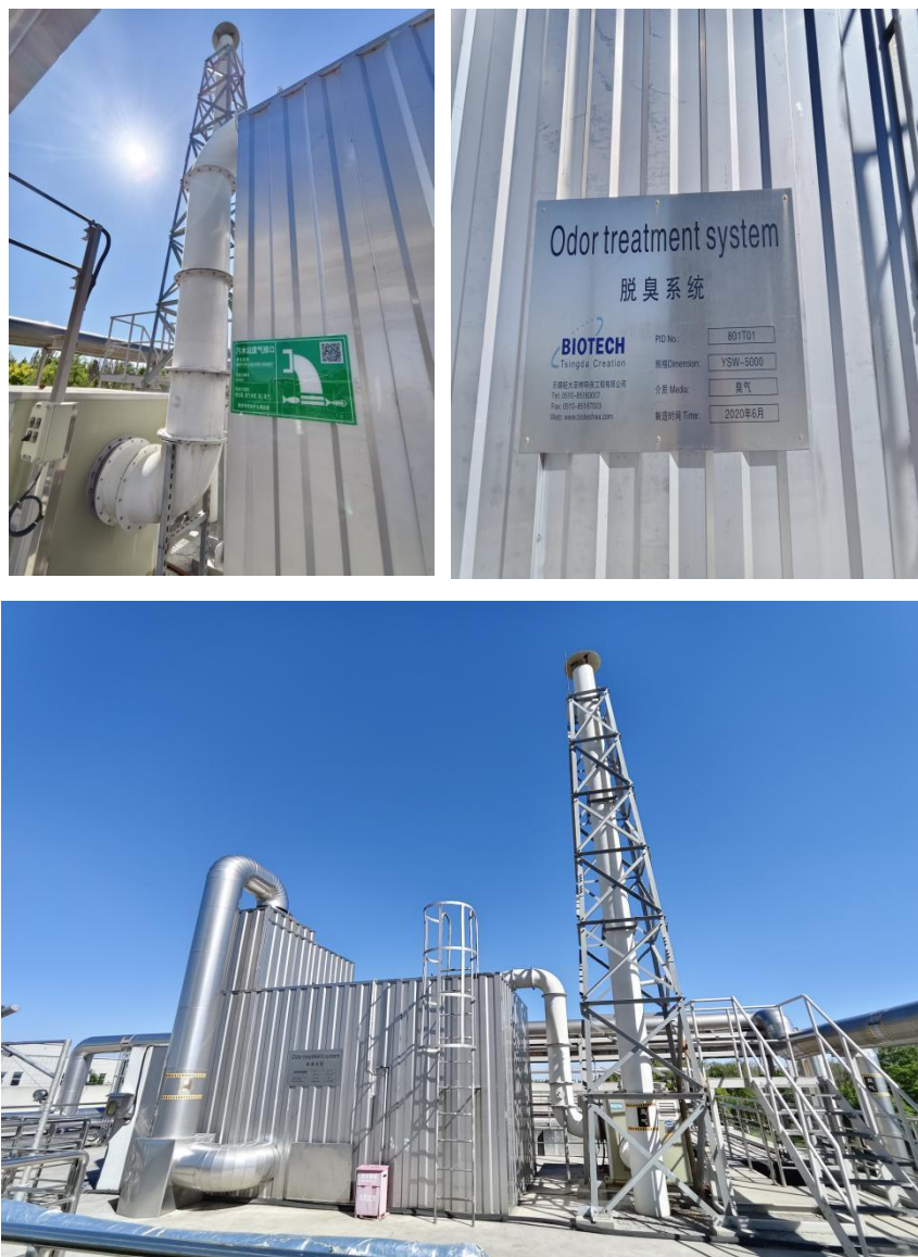
污水处理站废气排放口
