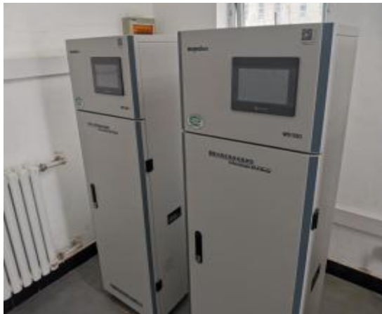
污水处理站在线监测设备
