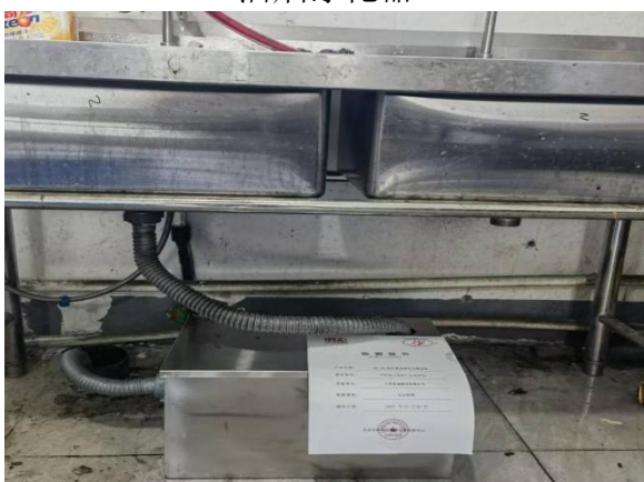
食堂洗手池下方油水分离器
