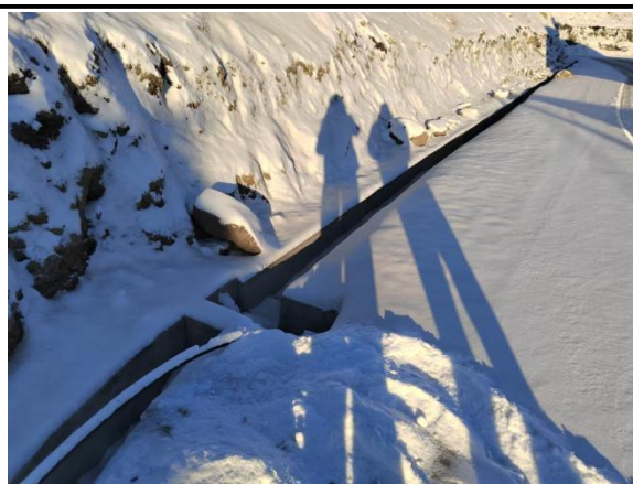
厂区四周排水沟
