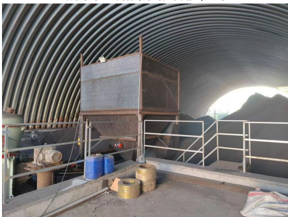
破碎生产线进料口（位于煤炭仓储库内）
