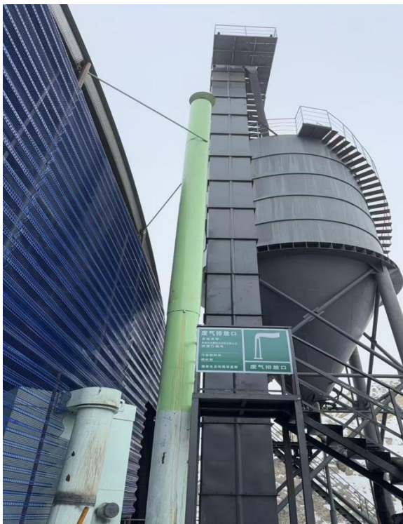
破碎粉尘排放口及粉煤储罐
