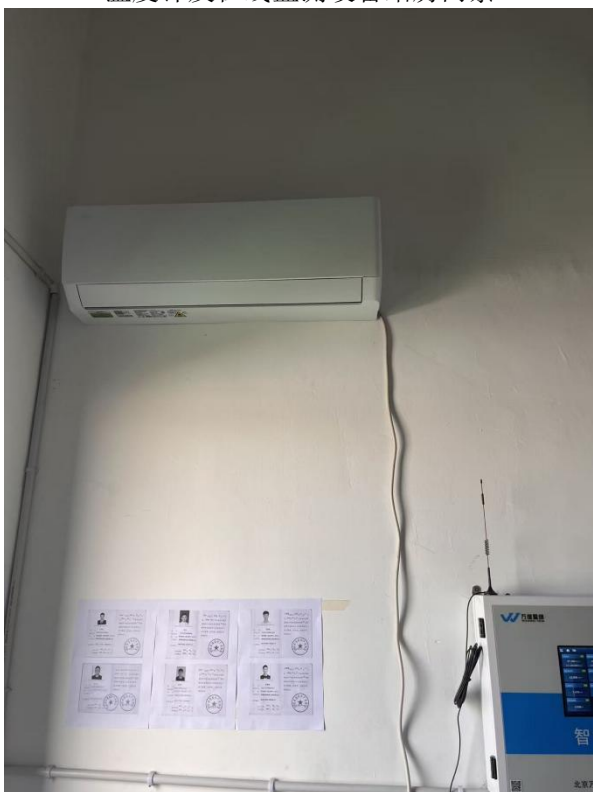
在线监测设备站房内空调
