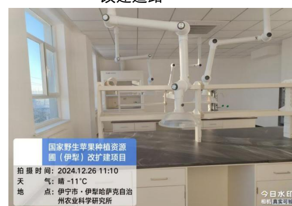
机械通风换气系统
