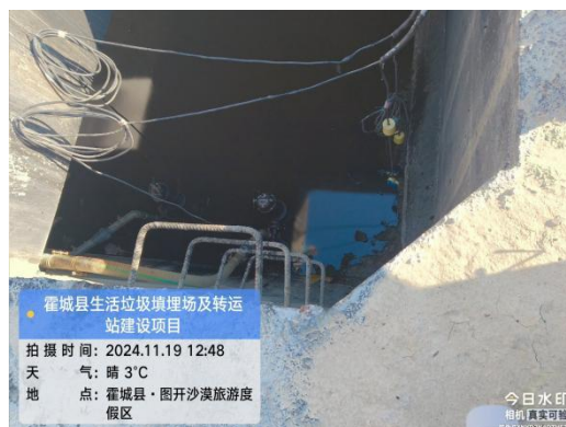
渗滤液调节池
