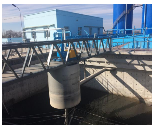
污水处理站内部
