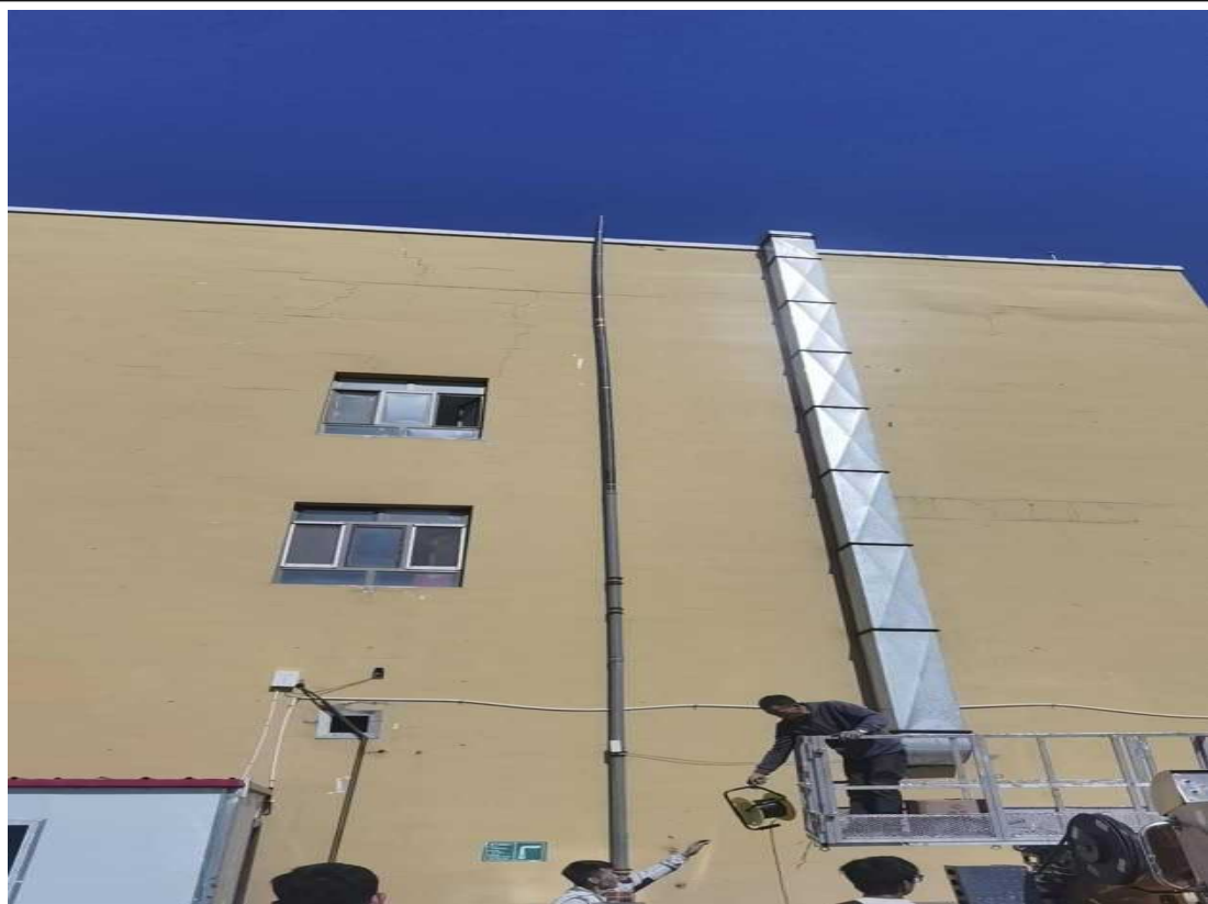
废气处理设施排气筒
