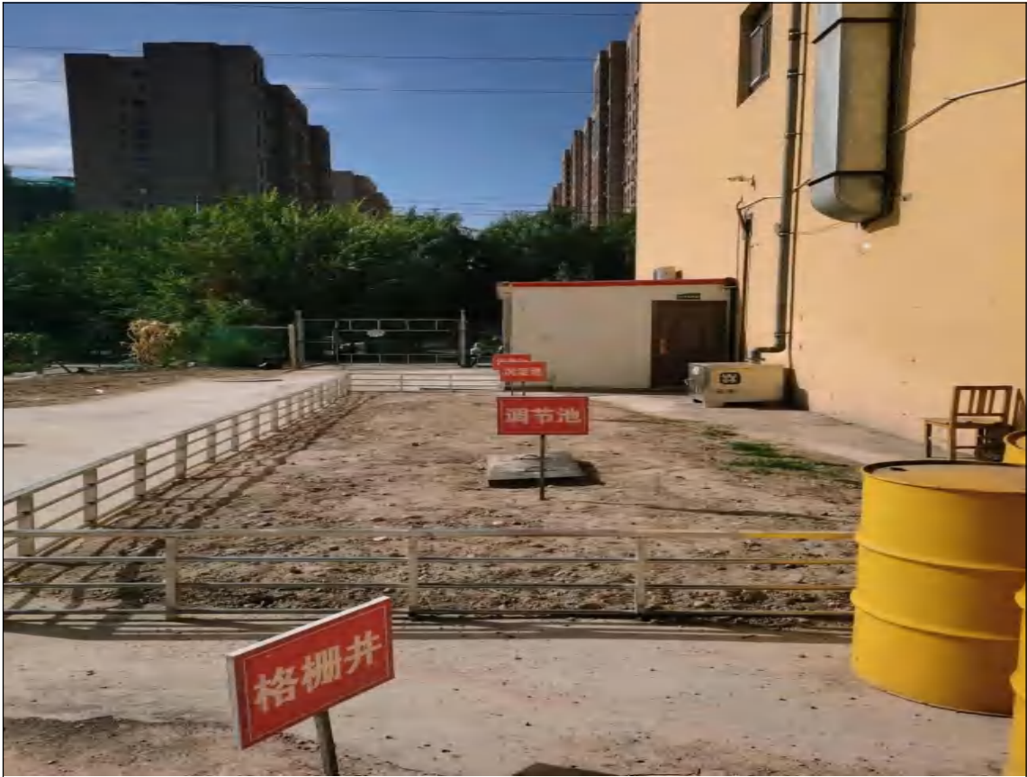
地埋式污水处理站
