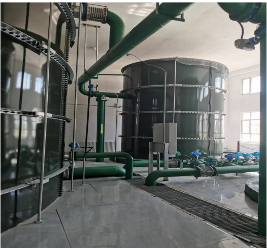
项目区水厂设备
